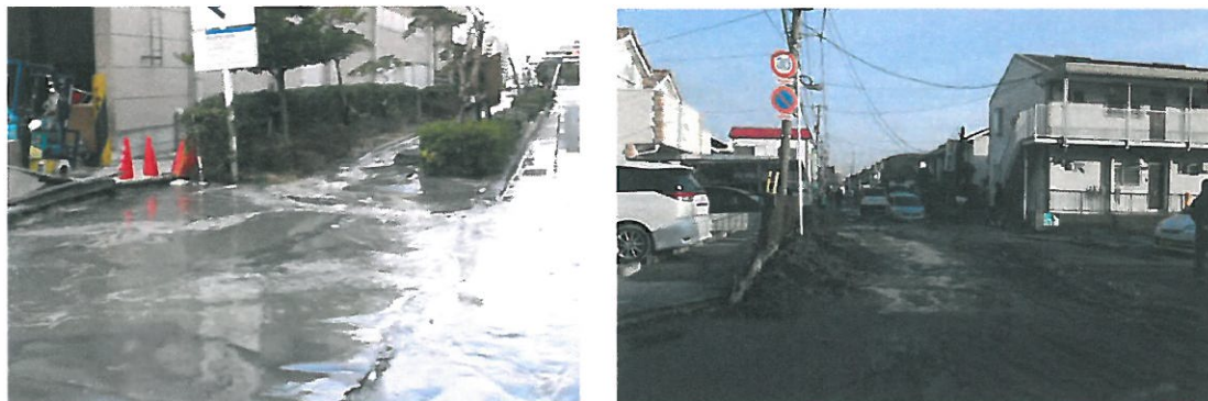
写真1・2 住宅地における液状化
